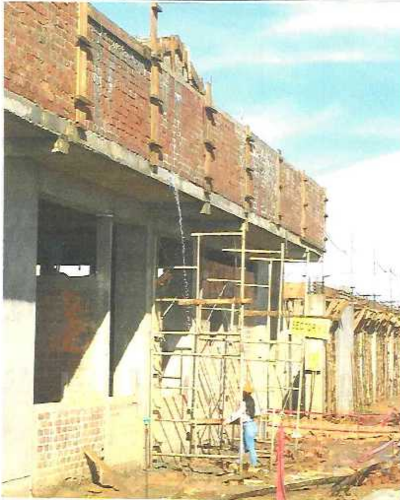
Encofrado de vigas y columnetas en parapetos pluviales en ambientes del Sector A-1, Bloque A-1.
