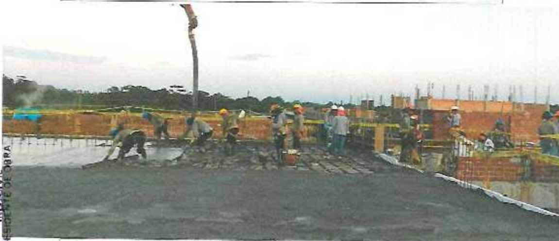
Vaciado de concreto f'c = 210 \text{ Kg/cm}^2 de losa aligerada en uno y dos sentidos en el Bloque A-6.
