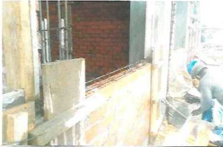
Encofrado de columnetas y vigas de confinamiento en ambientes del Sector A-1, Bloque A-1.
