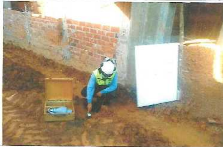
Ensayo de Saturación de Suelos en diversos sectores de la obra con fines de verificación.
