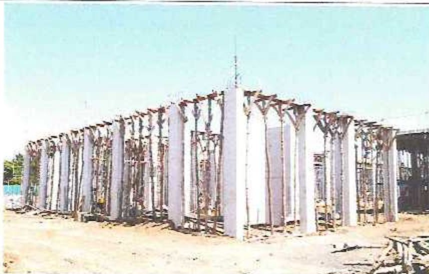
Encofrado de fondo de vigas y armado de vigas principales en losa maciza del Módulo C-3.
