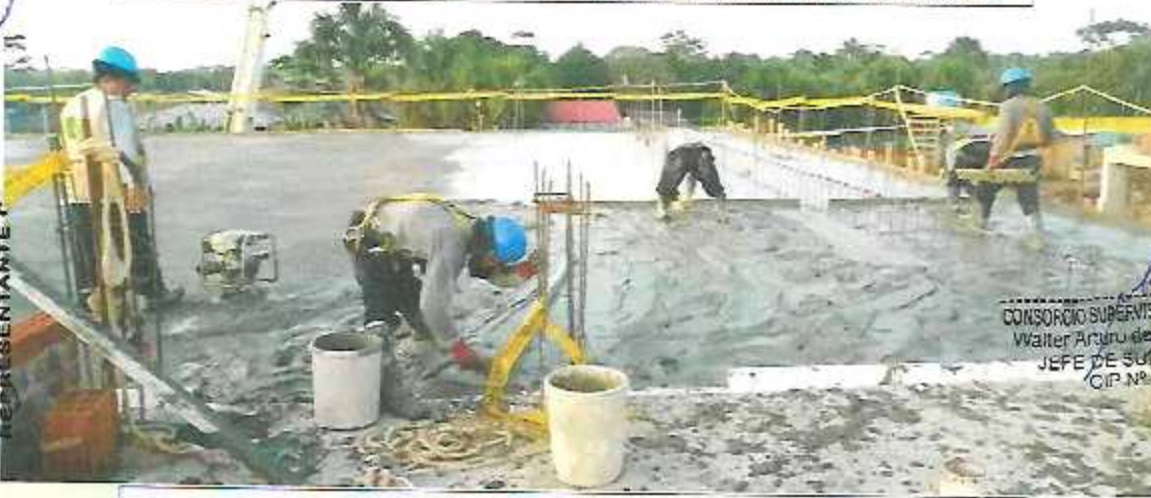
Vaciado de concreto f'c = 210 \text{ Kg/cm}^2 de losa aligerada en uno y dos sentidos en el Bloque A-6.
