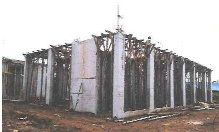
Encotrado de fondo de vigas y losa, y armado de vigas principales en losa aligerada del Módulo C-3.
